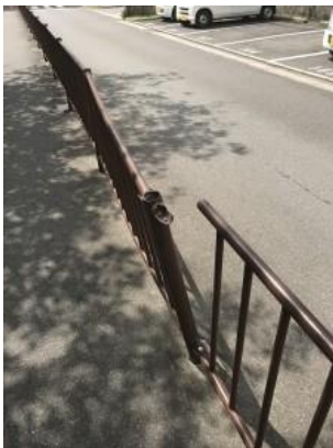
安全柵の破損
