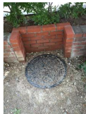
同上 マンホール環境整備（登町）
