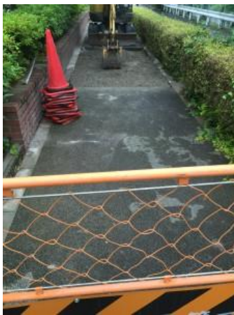
汚水管の不具合発見!!
