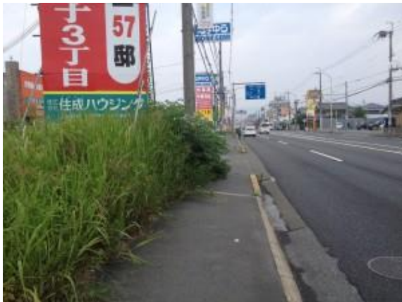
生い茂る雑草が国道170号線歩道の障害に・・・
