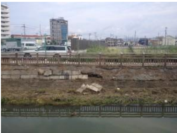
水路のり面崩壊 台風 11 号の影響か?
