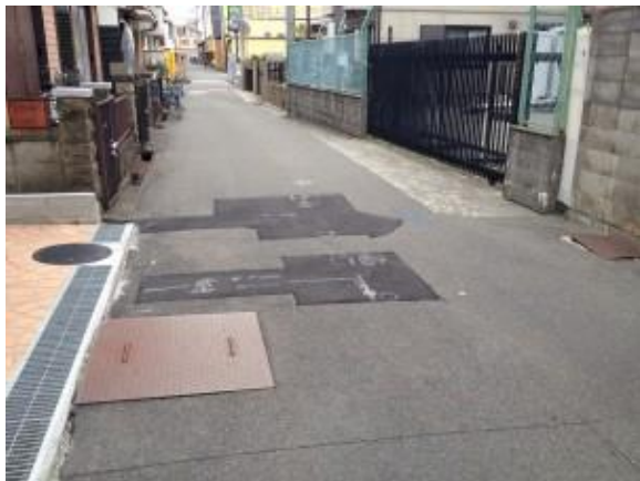
道路凸凹・下水蓋による自動車通過時の音被害
