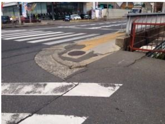
国道と市道の交差点に危険な段差
