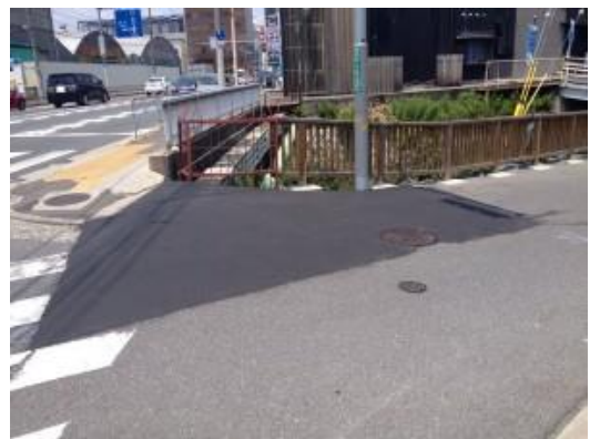
No.375 段差解消（深沢1丁目）
