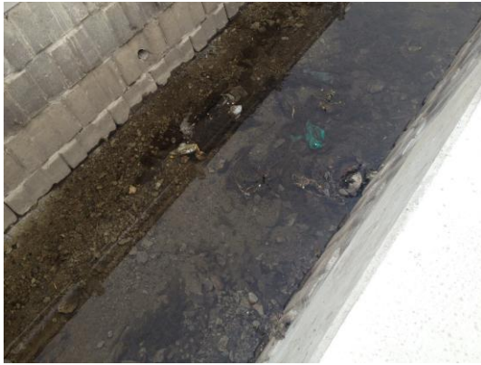
水路工事後の瓦礫が散乱
