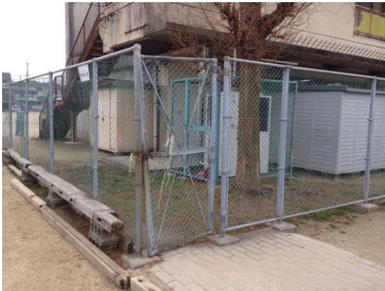
公園フェンスに穴・扉歪み
