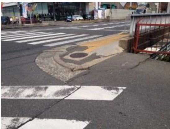
国道 170 号線歩道に凹み・危険
