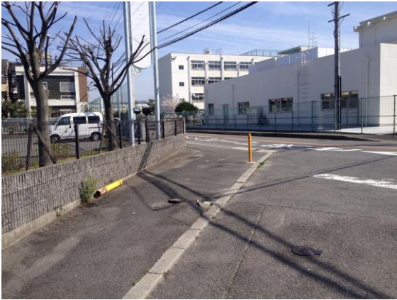
歩道・安全ポール破損
