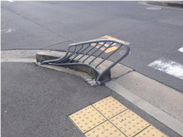
交差点の安全柵破損
