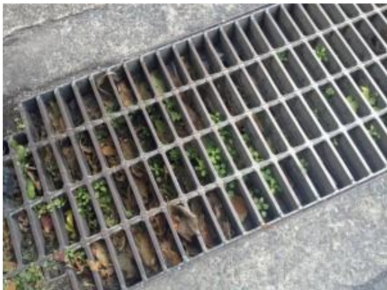
雑草等による側溝内の目詰まり
