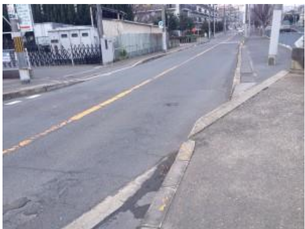
道路の劣化による危険な凸凹
