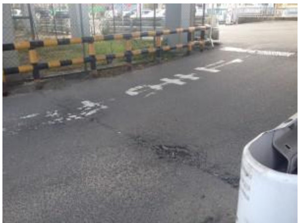
道路の劣化による危険な凹
