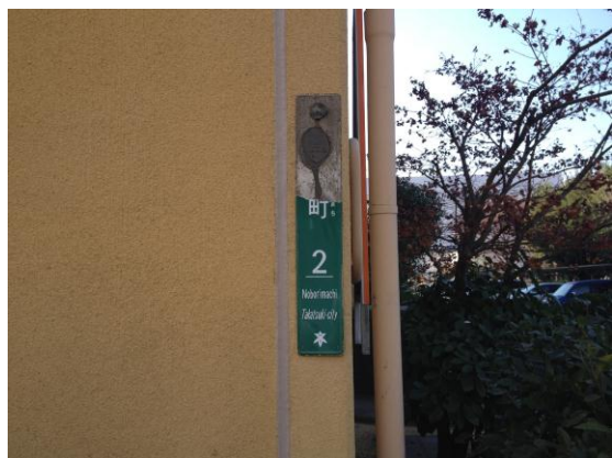
住所銘板破損
