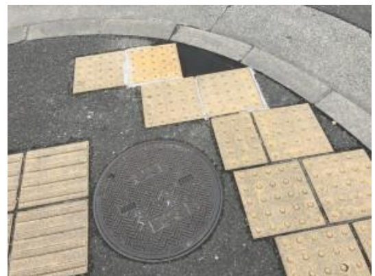
No.474 点字ブロックの補修（大塚町）
