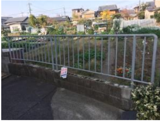
行き止まり柵の老朽化
