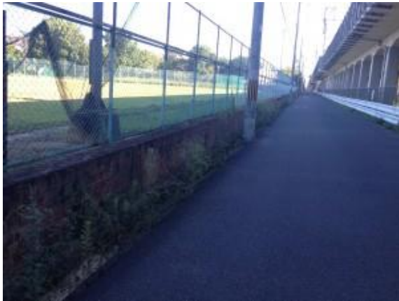
側溝に雑草 雨水の流れが心配
