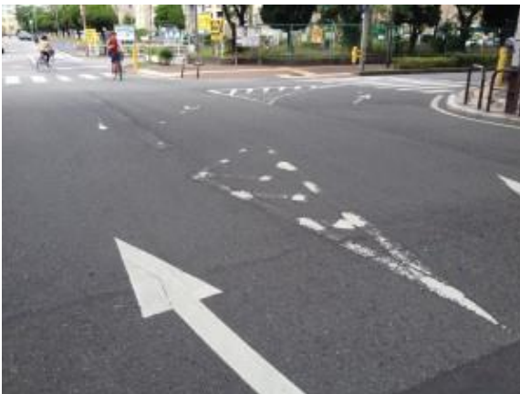
交差点路面標示が劣化・トラブルも
