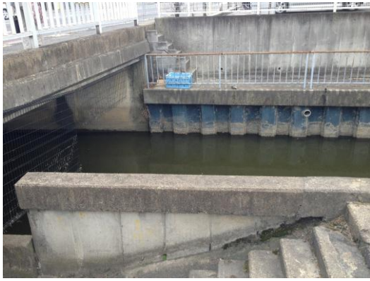
水路に安全柵がないのは危険では？
