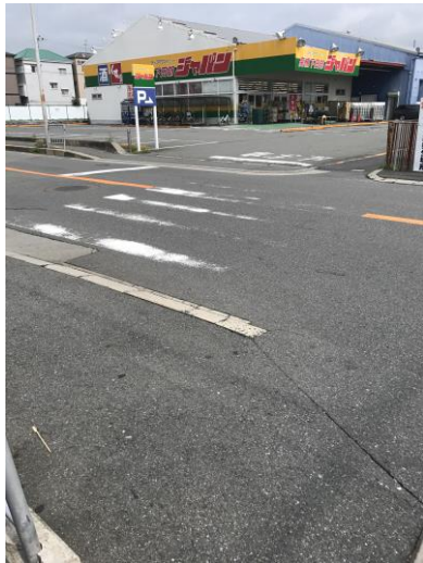
横断歩道の劣化、安全低下
