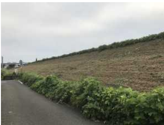
雑草で側溝が隠されて自動車が脱輪
