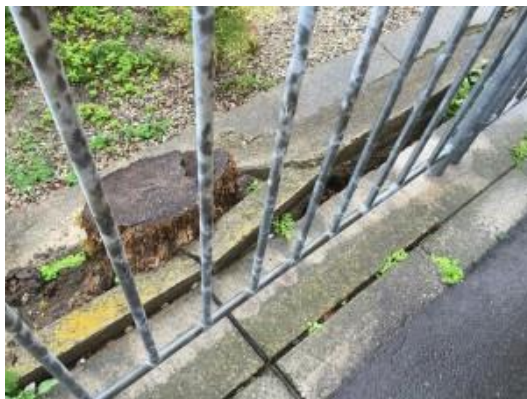
水路のり面と道路の境目に亀裂・隙間?
