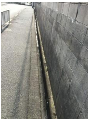
細くて深い側溝が危険!!
