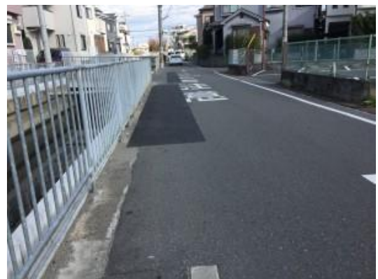
No.472 水たまりの補修（北大樋町）
