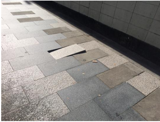
歩道のキケン・化粧タイル剥離
