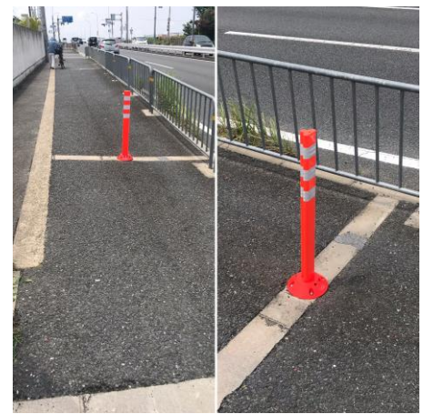
No.573 腐食しないポールに改善され修理完了（大塚町）
