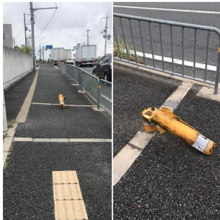
歩道のポールが腐食して破損
