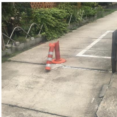
ポール型バリカーの破損
