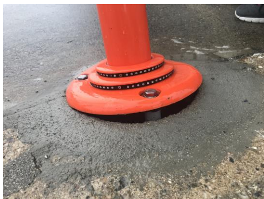
ポール型クルマ止めの改修後の破損
