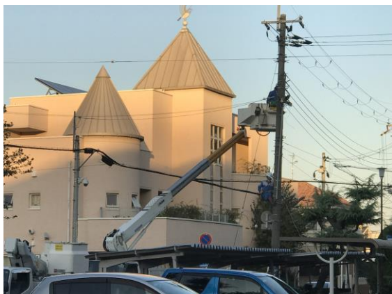
Before 地域の保育園付近に暗い箇所あり
