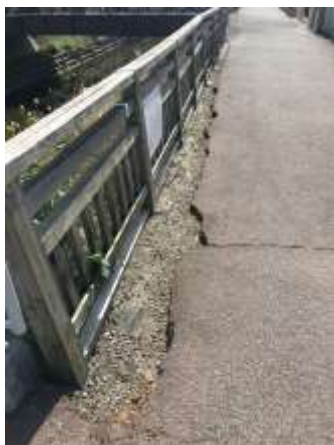
保育園前歩道の亀裂
