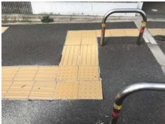
点字ブロックのガタツキ（府道）
