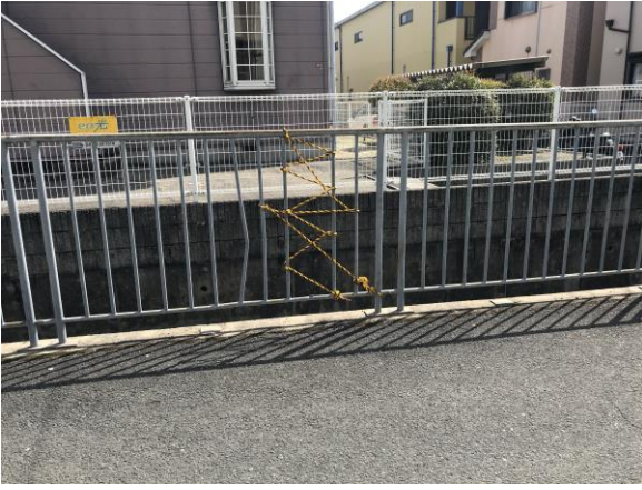
水路の転落防止策の破損、子ども達が……応急処置
