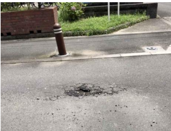
一方通行の道路に凹部、非常にキケンとの通報
