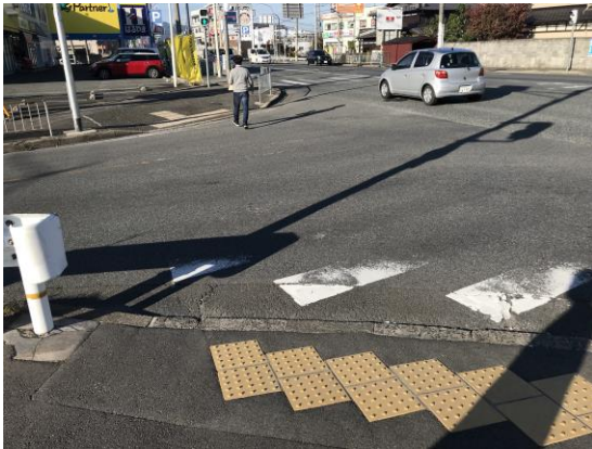
国道 170 号と府道の交差点、横断歩道が薄くなってキケン
