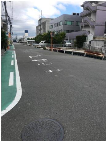
道路標示が薄くなってキケン
