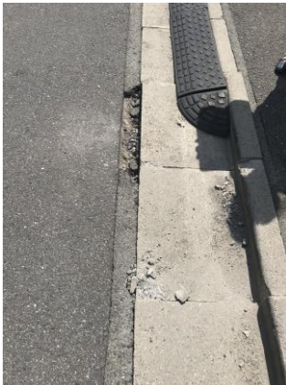
L 型側溝に隙間やガタツキ発見!!
