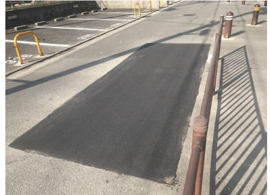
No.508 劣化した道路の部分補修（登町）
