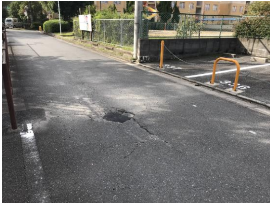
劣化や凹み道路がキケン。緊急対応も
