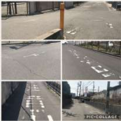
生活道路に通じる路面標示の劣化
