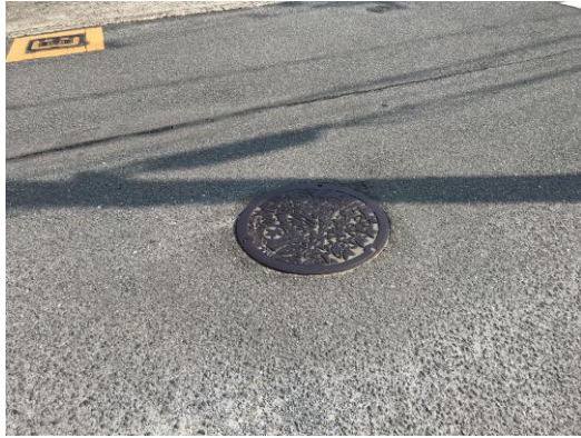
道路の段差、大型車通過時の振動改善要望
