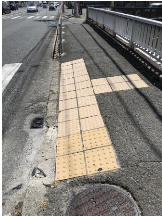
国道 170 号沿いの歩道端が破損してキケン
