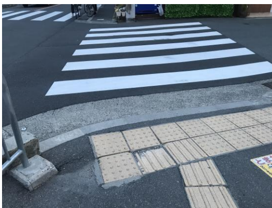
横断歩道前の点字ブロック陥没
