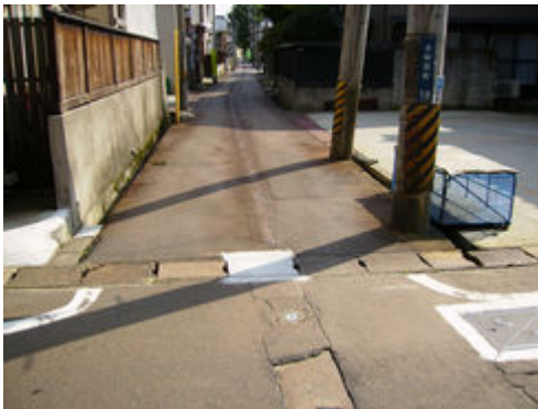
北四日町地内(蓋の改善)
