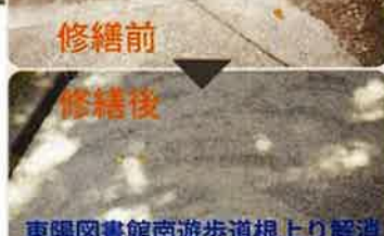
東陽図書館南遊歩道根上り解消
